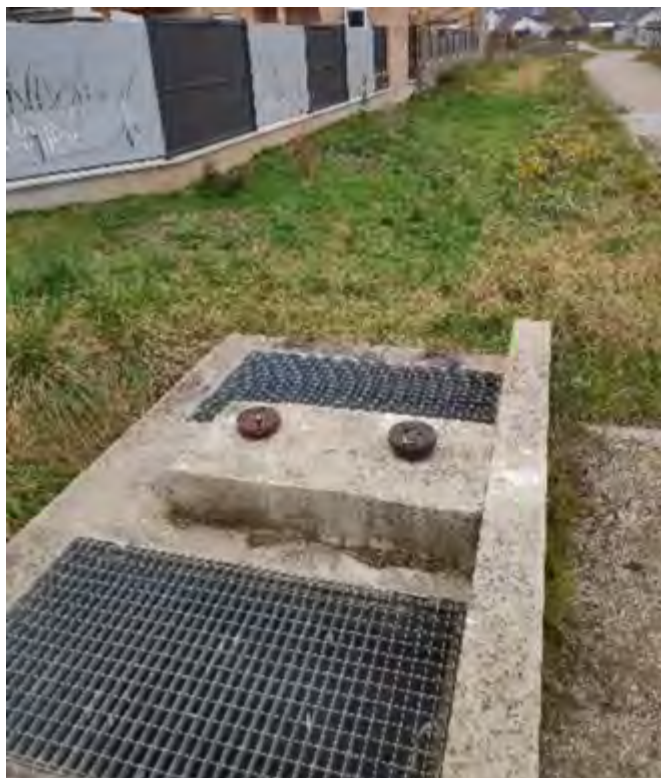
Photo de la noue, la partie végétale, en dessous de laquelle sont enterrées les caisses. La partie bétonnée correspond au système d'évacuation en cas de trop plein.
