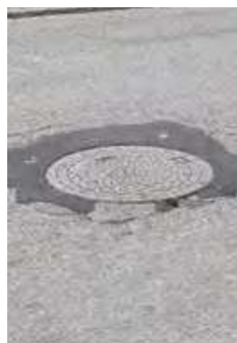
Tampon abimé : vibre lors du passage des voitures
