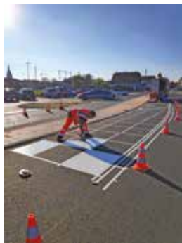
Le damier réservé au stationnement des bus est constitué d'une résine spéciale qui n'a besoin que de quelques minutes pour sécher.
