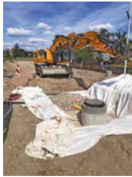
Les eaux de pluie de la rue Louis Pasteur ne sont plus reliées au réseau d'assainissement communal (détails à la page suivante).
