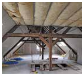
Une nouvelle isolation a été placée sous les combles afin d'améliorer les performances énergétiques de ces logements.
